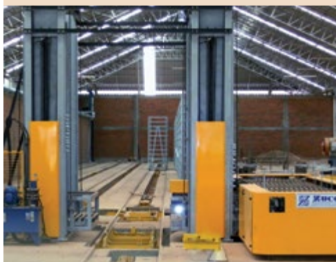
Automatismo de Carga
