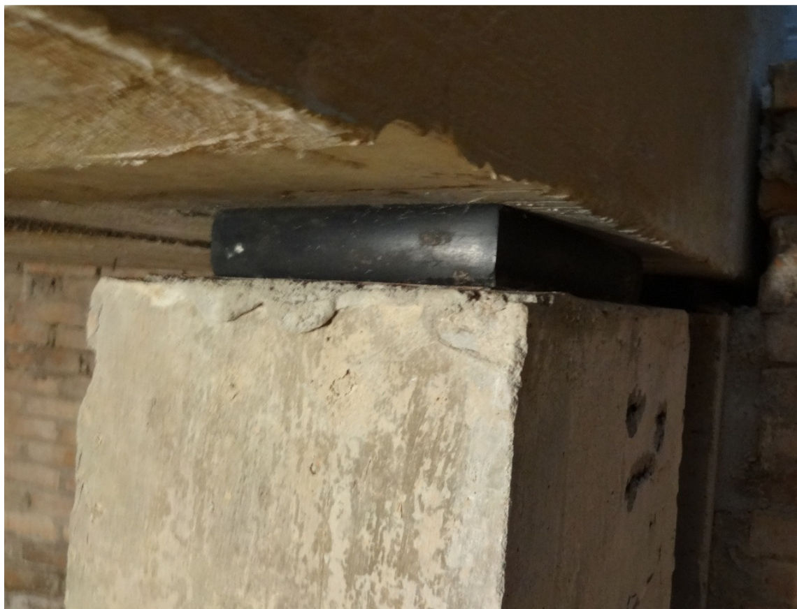
Figura 51 - Borracha antivibração utilizada para apoio da câmara reverberante
