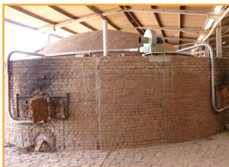
Insuflamento de ar de combustão
