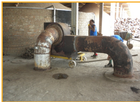
Exemplo de dutos para pré-aquecimento
