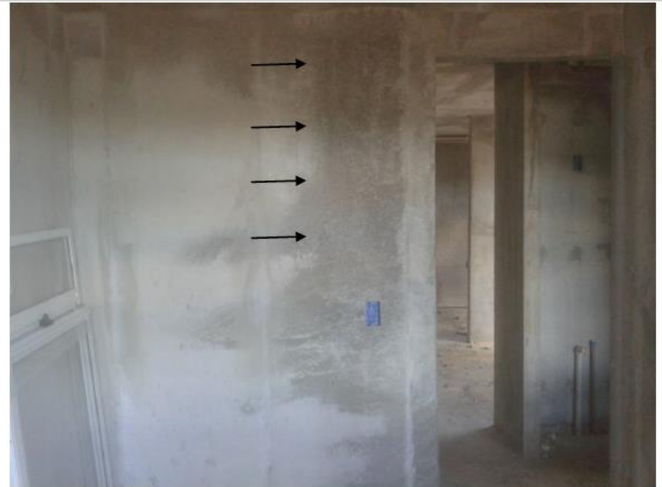
Figura 17 – Defeito B: Segregação do concreto entre 1,2 a 2m acima do piso
