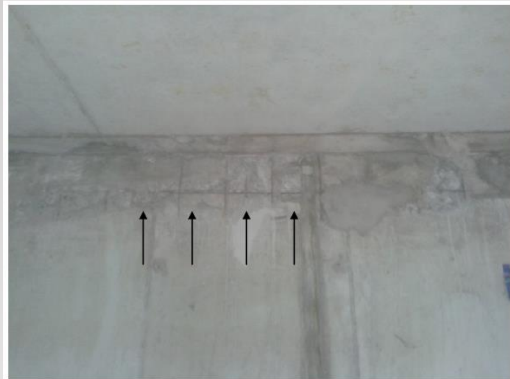
Figura 19 – Armadura exposta: Ferragem exposta na superfície da parede
