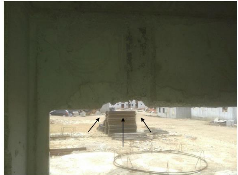
Figura 21 – Defeito contramarco: Contramarco das janelas quebrado
