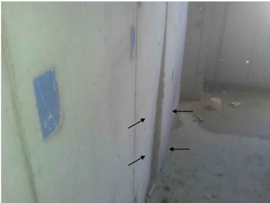
Figura 22 – Abertura placas: Aumento indesejado na espessura das paredes
