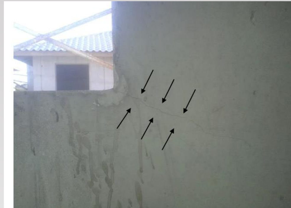
Figura 9 – Fissura 45°: Fissuras a 45° de aberturas de portas e janelas
