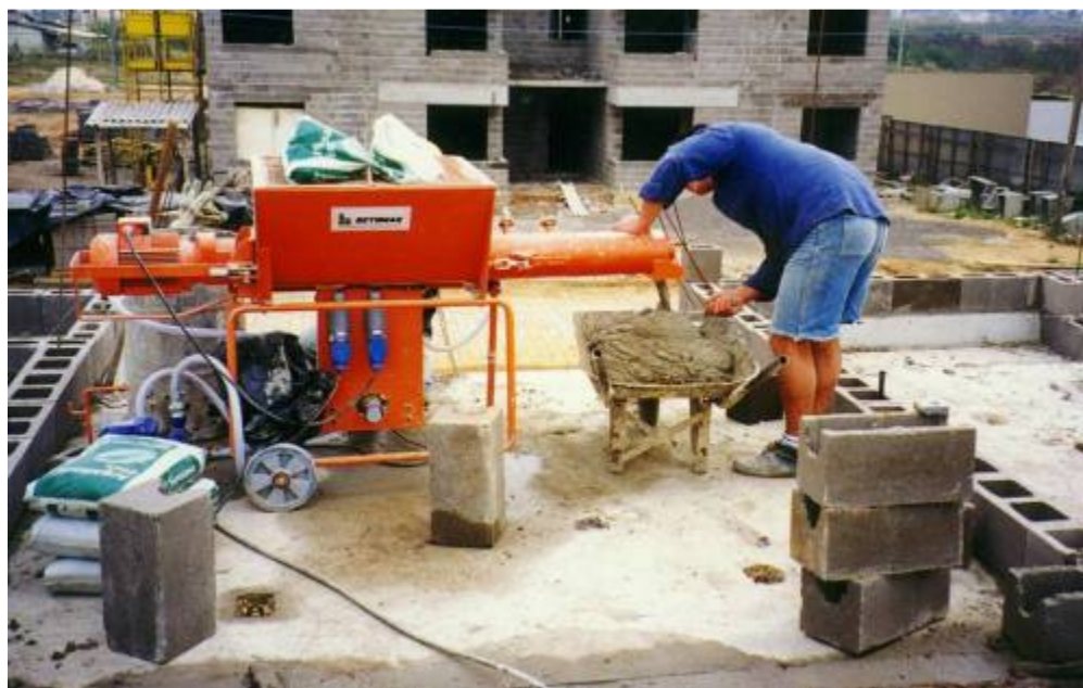
Figura 11 – Misturador de argamassa industrializada com eixo horizontal localizado próximo à alvenaria em execução.
