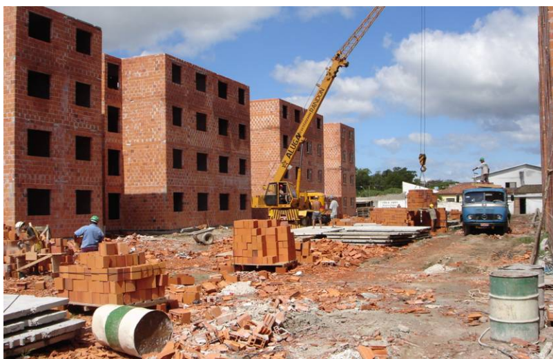
Figura 61: desperdício de blocos em excesso
