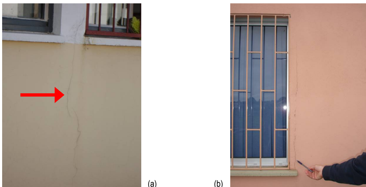
Figura 34: (a) fissura vertical na face externa da parede que divide duas áreas de serviço; (b) fissura vertical do revestimento de argamassa da lateral do vão da janela
