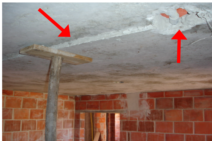
Figura 59: desnível acentuado no encontro dos painéis de lajes da sala e desencontro das tubulações das instalações elétricas
