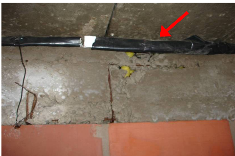
Figura 55: detalhe da junta deslizante do último pavimento sobre a cinta de respaldo
