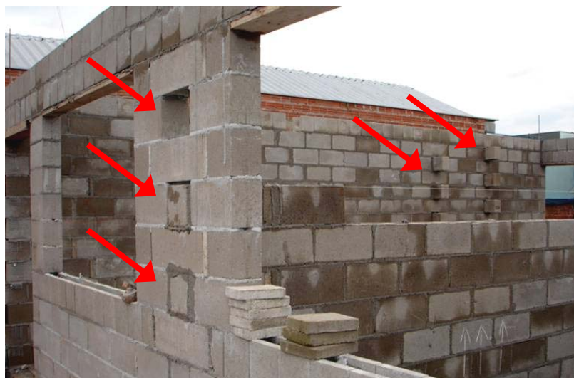
Figura 50: amarrações inadequadas das paredes do tipo “bocas-de-leão” no empreendimento E1IP9
