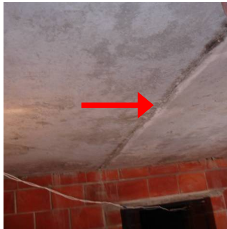
Figura 63: acabamento inadequado dos painéis de laje da sala
